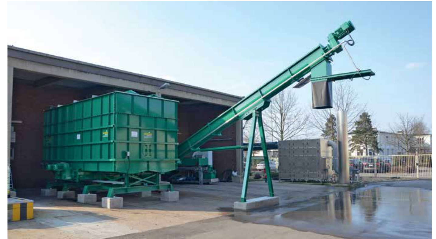
HUNING Schlammstapelbehälter (SSB) mit eingehauster Förderschnecke zur Beladung der Abfuhrcontainer per Sattelzug
